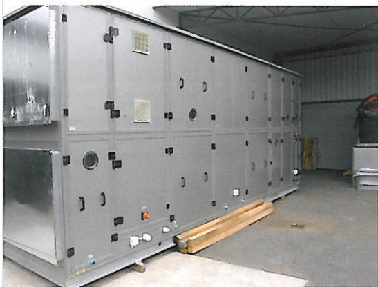
Großanlage für den Einsatz in einer Therme.
